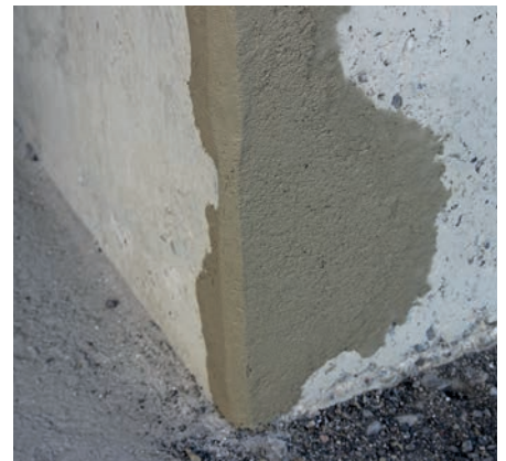
Uitstekend geschikt voor het herstellen van gebarsten betonoppervlakken, ook ter hoogte van sokkels
